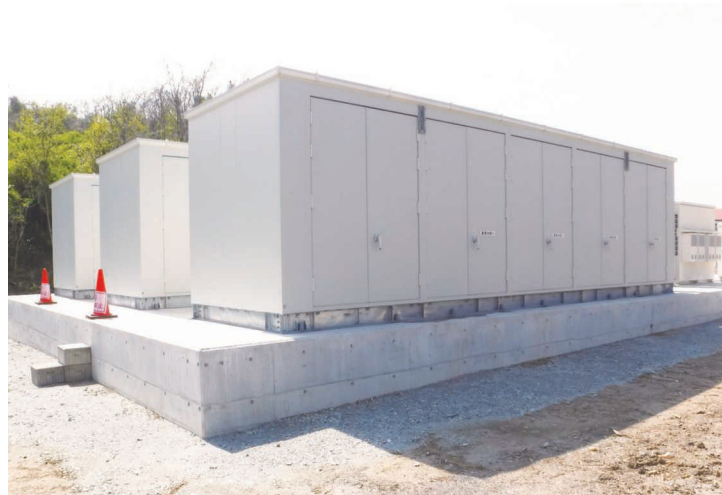
系統用蓄電システム
