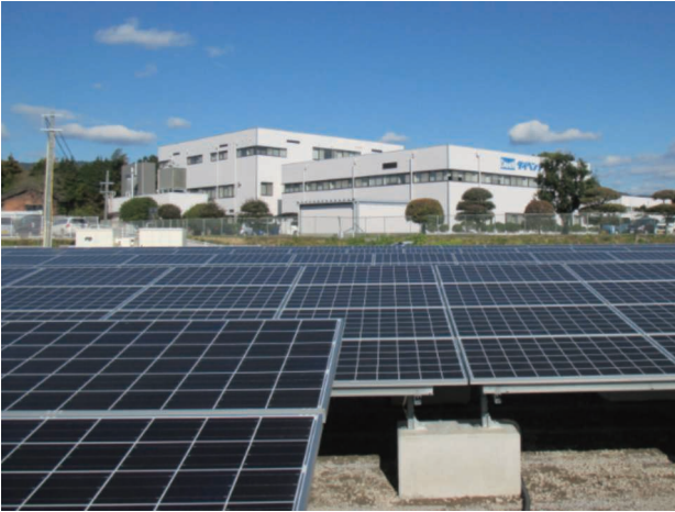
太陽光発電設備(大分事業所)
