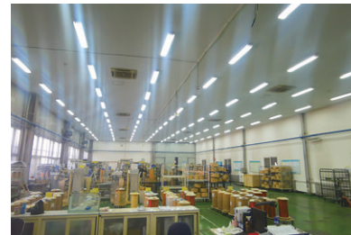
LED照明 巻線室
