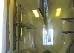
粉体塗料自動塗装設備内部
