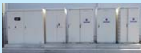
②-2：ダイヘンテック実証設備（蓄電池システム）
