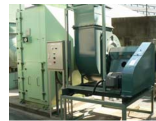
脱臭装置(兼平工場)
