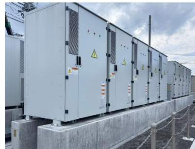
NC 唐津市浜玉町浜崎蓄電所
