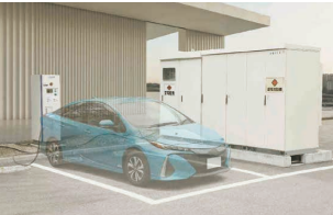
非常用電源「V2Xシステム」
