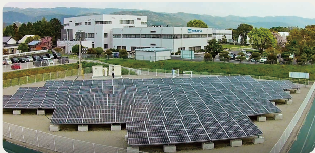
太陽光発電システム
