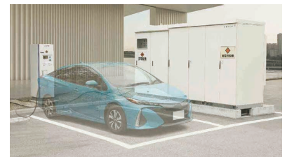
非常用電源「V2Xシステム」
