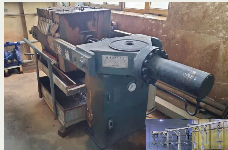
汚水処理装置
