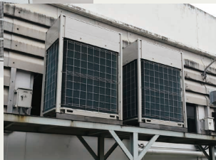
更新後の空調室外機
