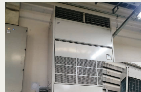
更新後の空調室内機
