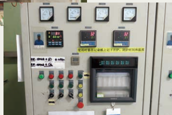
乾燥炉操作盤
