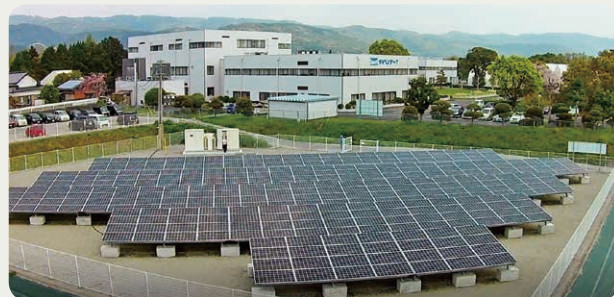
太陽光発電システム
