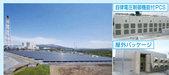
図3. 伊達ソーラー発電所に納入されたPCSおよび屋外パッケージ
