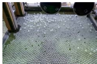
塗装下地処理槽の保温ボール
