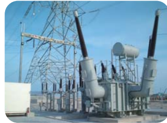
超高压変圧器
