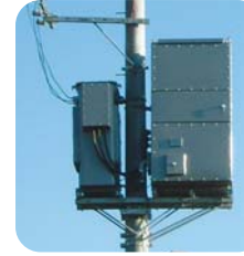
電圧変動補償装置
