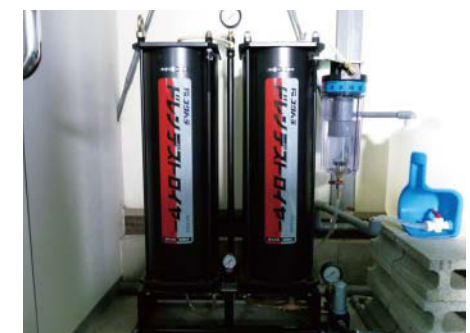
油水分離 装置
